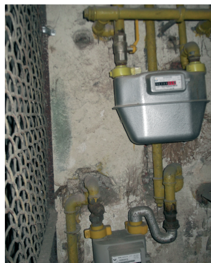
3. Kolejny przykład zaniechań – widoczne wycieki z instalacji gazowej
